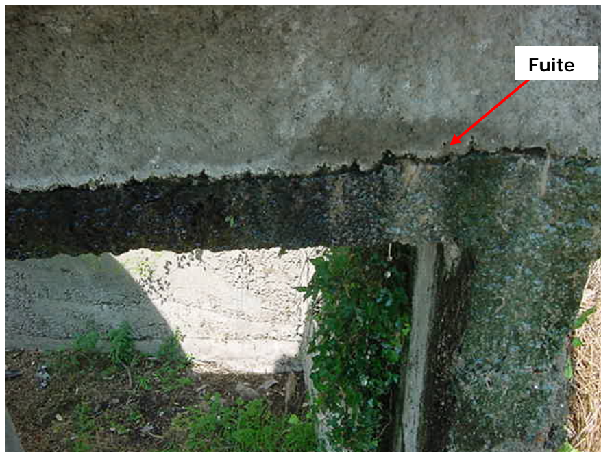
Photo 1 : fuite relevée sur le canal d'entrée de la station du village :
